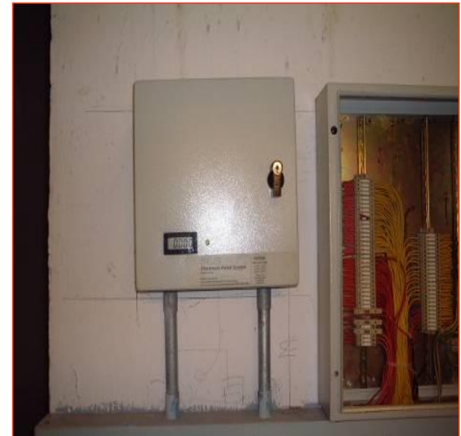
Nainštalovaná riadiaca jednotka elektroosmózy Triton
